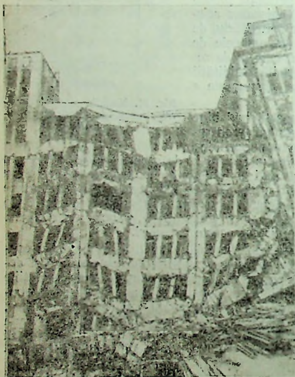
Fig. 82. Clădirea Daiwa după cutremurul din Fukui (1948).
