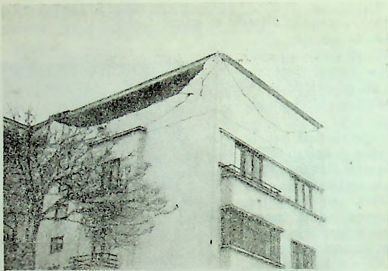
Fig. 128. Crăpături și surpări de ziduri de atic. Cutremurul din 10 noiembrie 1940, de la București.
