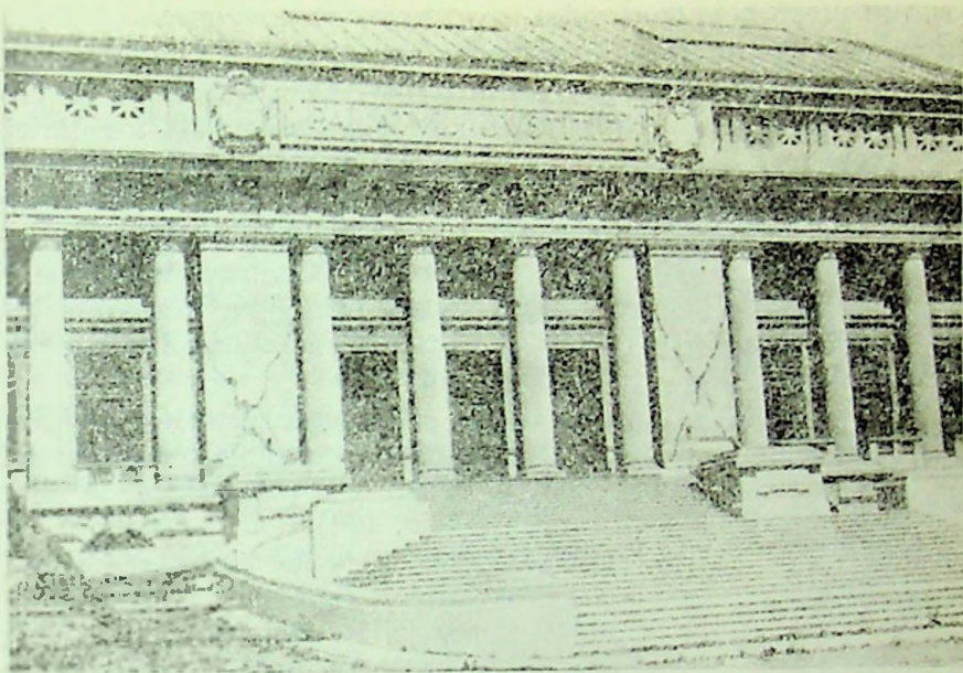
Fig. 124. Crăpături caracteristice pentru zidărie cu mortar slab și rosturi neumplute. Cutremurul din 10 noiembrie 1940 ; Ploiești.
