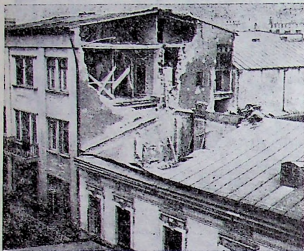
Fig. VI.6. — Calcan prăbușit la cutremur la o clădire veche de zidărie (București, str. Șelari 9 — 11, parter și 3 etaje) Prăbușirea calcanului a produs avarierea acoperișului la clădirea învecinată.
