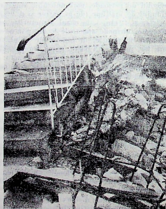
Fig. VI.42. — Clădire de locuit la Valea Călugărească, județul Prahova. Clădire nouă cu structura în zidărie și beton armat monolit (parter și 3 etaje): a — Vedere de ansamblu după cutremur a clădirii prăbușite pe verticală cu circa 3 m (un nivel) prin ruperea stîlpilor de la parter; b — Vederea stîlpilor parterului ruși la partea superioară și rezemați de pereții nivelului superior; c — Ruperea scării interioare.
