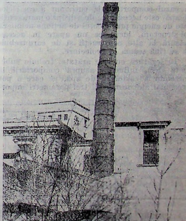
Fig. VI.102. — Coș de fum din zidărie de cărămidă rupt la cutremur în treimea superioară, cu deplasarea porțiunii de sus a coșului (Centrală termică, în București, str. Matei Milo).
