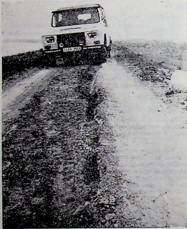
Fig. V.39. — Fisură longitudinală pe coronamentul unui dig din lungul râului Buzău, produsă la 4 martie 1977.
