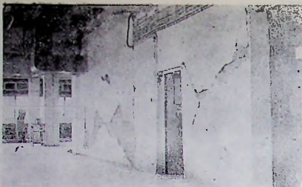
Fig. VI.98. — Întreprinderea CONECT, București. Hall de fabricație cu structura combinată (stâlpi și sîmbure central din beton armat monolit și planșee prefabricate — parter și 5 etaje): — Fisuri și rupturi în diafragmele sîmburelui central de la etaj I.
