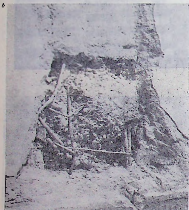
Fig. VI.40. — Blocul de locuințe din București, str. Dumitru Petrescu 85. Clădire nouă cu diafragme de beton armat monolit (parter și 10 etaje): a — Vedere de ansamblu; b — Avarii exterioare la capătul unei diafragme.
