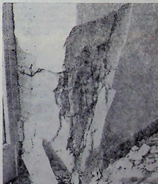
Fig. VI.35. — Blocul de locuințe „Dinamo 6” din București, șos. Ștefan cel Mare. Clădire nouă cu diafragme de beton armat monolit și parter flexibil (parter și 8 etaje): a — Vedere de ansamblu; b — Avarii la stâlpii fațadei laterale; c — Stâlp avariat la parter.
