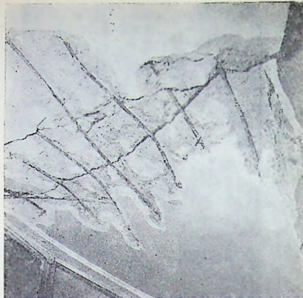
Fig. VI.22. — Avarierea rampei unei scări de beton armat, la blocul de locuințe vechi din Str. Galați nr. 21 București.
