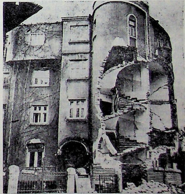
Fig. VI.5. — Prăbușirea zidăriei de la casa scării la o clădire veche din zidărie portantă (București, str. dr. Brindză, parter și 3 etaje).
