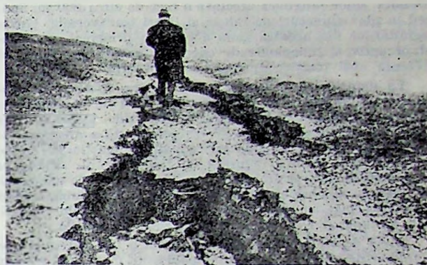
Fig. VI.115. — Crăpături în diguri de pământ, cauzate de cutremur.
