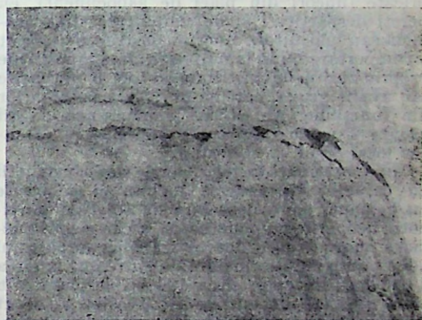
Fig. VI.112. — Avarii provocate de cutremur la silozurile noi de cereale: a — Beton distrus și armătură dislocată la un nod de cadru (siloz Orbeni-Bacău); b — Fisuri orizontale în pereții celulelor la silozul Focșani.
